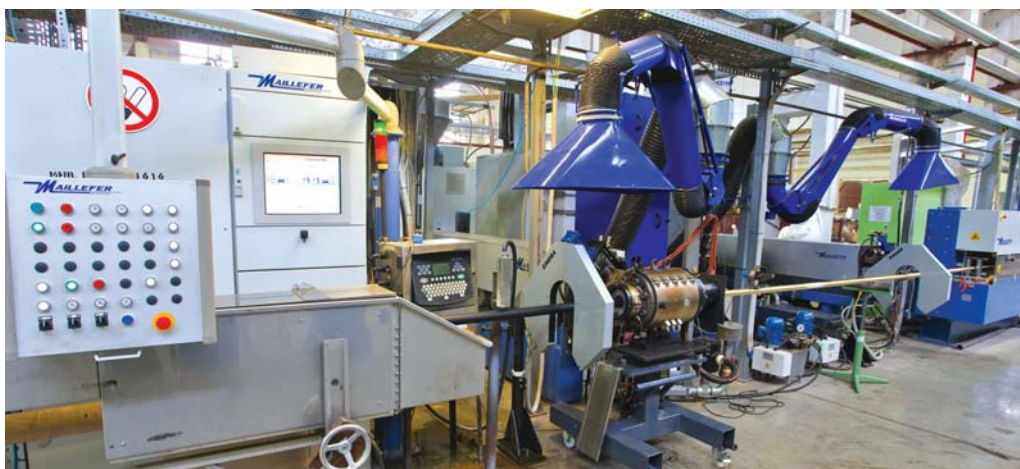
Фото: Линия ошлангования EEL 60–241 Mailefer для кабелей с изоляцией из сшитого полиэтилена
